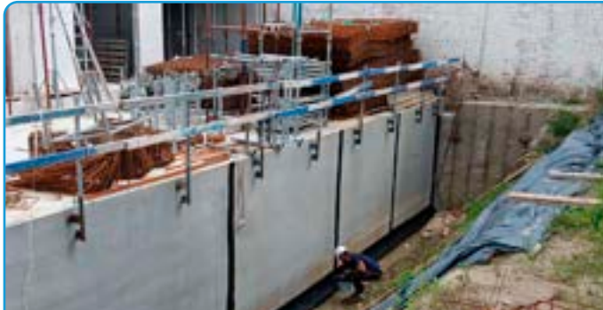
MAANALAISTEN ELEMENTTILIITOSTEN VEDENERISTYS
