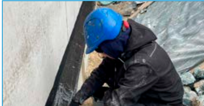
MAANALAISTEN ELEMENTTILIITOSTEN VEDENERISTYS
